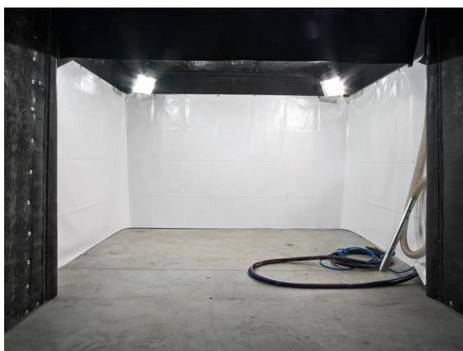
Interiér komory s pneumatickým odsáváním.
